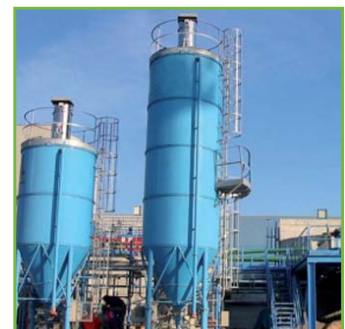
» FILTROS DE PURGA SILOS
