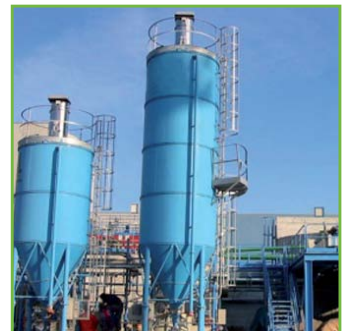
» VENTILACIÓN DE SILOS
