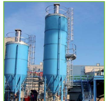
» SILOS VENT FILTERS
